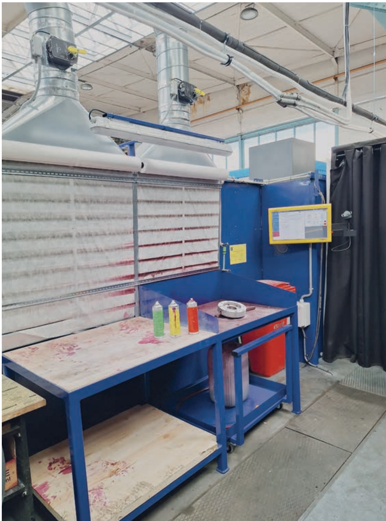
Nové pracoviště pro kapilární polévací zkoušky
