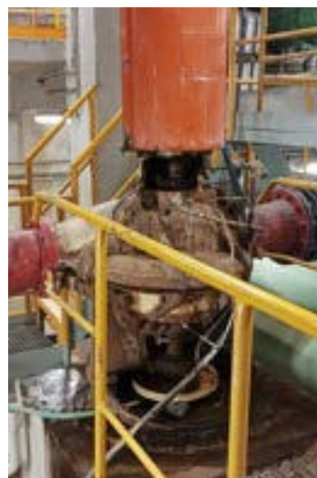
2 Původní stav – čerpadlo
