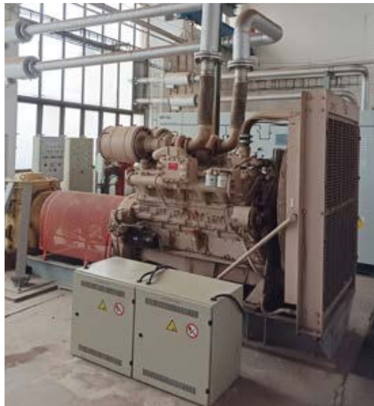
1 Původní stav – diesel
