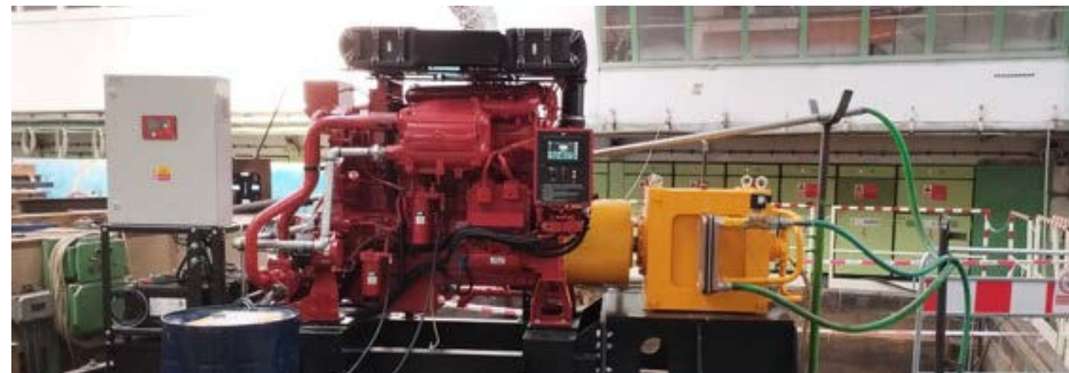
4 Pohled na dieselmotory Caterpillar ve skladu dodavatele, výkon 447 kW.
